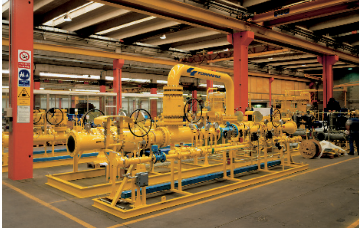
FIG|05 Stazione di regolazione e misura del gas.
